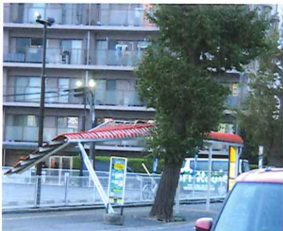
辰巳団地バス停屋根の倒壊
